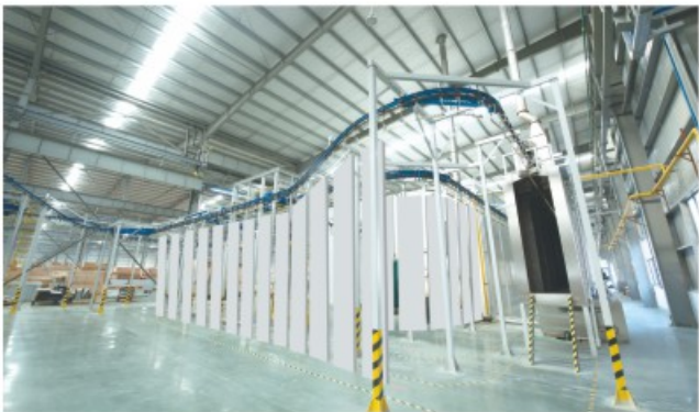
德国进口瓦格纳喷涂生产线
